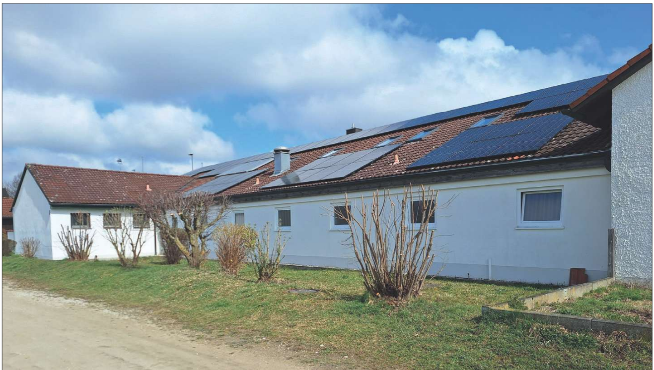
Photovoltaikanlage auf dem Umkleidegebäude.
